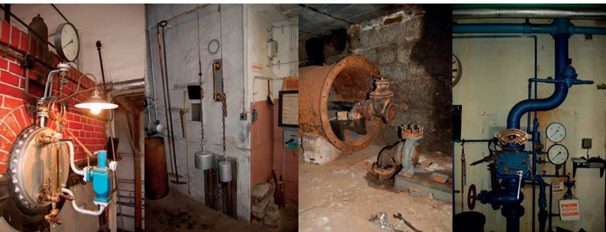
Bílý Potok, details z kotelny, potrubí v turbínové kašně a armatury sprinklerového zařízení. Foto M. Ouhrabka, 2009. • Bílý Potok, details of the boiler, the pipes in the turbine and the sprinkler system. Photograph by M. Ouhrabka, 2009.
