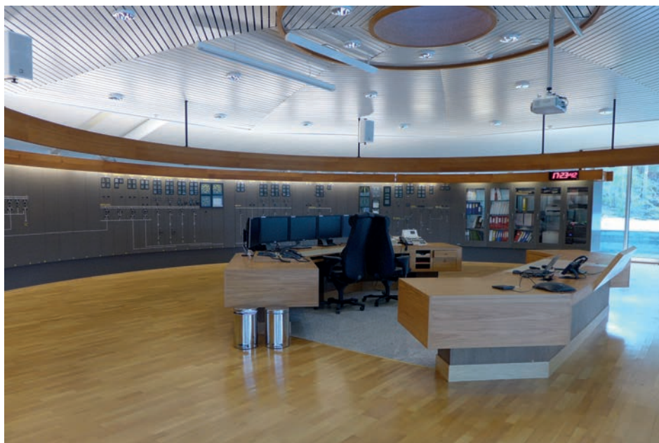
Suldal, hydro-electric power plant. Photograph by Michaela Ryšková, 2015. • Suldal, vodní elektrárna, velín. Foto Michaela Ryšková, 2015.
